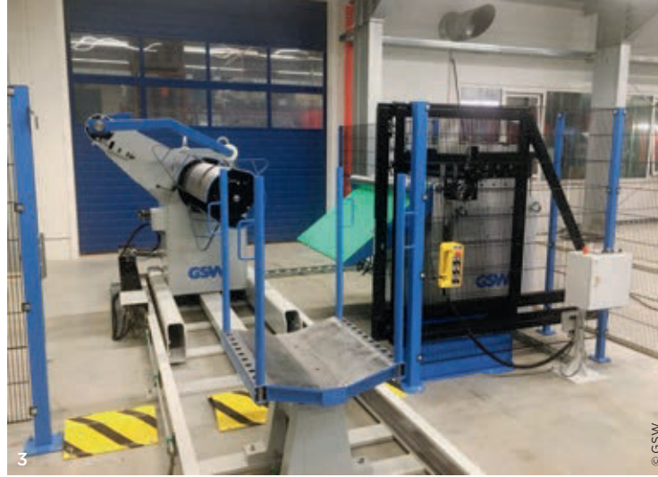
3 Damit fängt alles an: Haspel und - hinter dem Gitter zu ertahnen - Richtmaschine. Auf den freien Platz rechts der Richtmaschine kommt demnächst die Entfettungs- und Reinigungsanlage.
