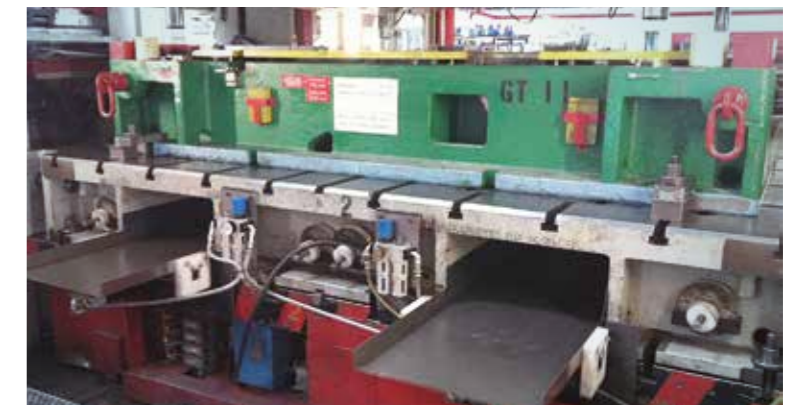
Links: Detail Einbau PS100-Gerät mit leichter Rinnenkonstruktion Rechts: schwere Einrichtung mit zwei PS60 mit Großrinne und verstärkten Haltern
